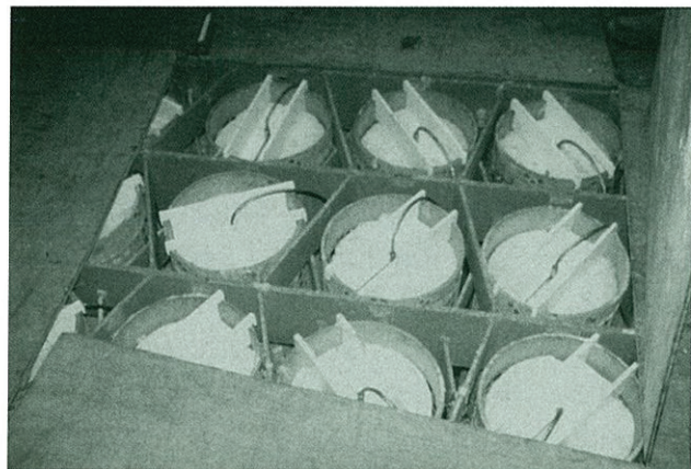
格納容器緊急冷却設備（アイスコンデンサ）に氷を使用している
