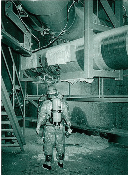
ナトリウム漏洩後の状況 (1995年12月9日撮影)
